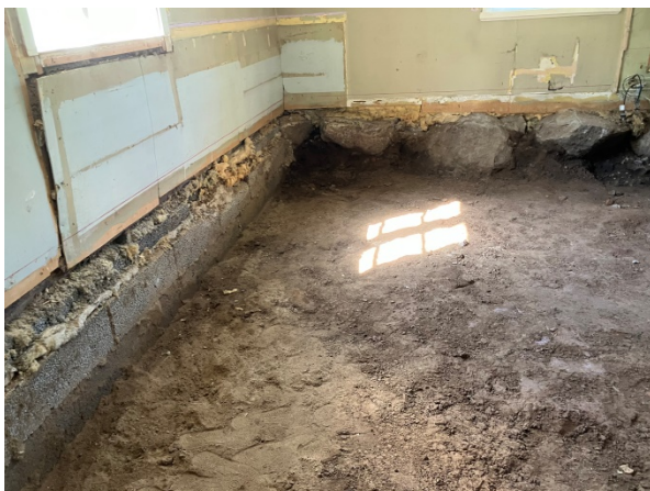
Bild 11 vid utgrävning-schakt visar sig en blandning av grundsulan utförd med Lecablock och större stenblock som grundläggning av
