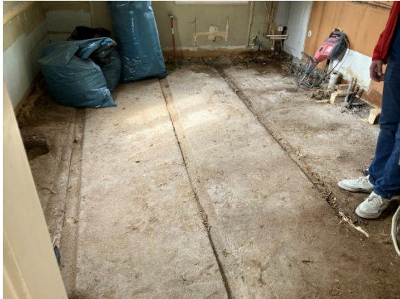
Bild 4 – Start av rivning bottenbjälklag – visar del av Btg-platta i Kök
