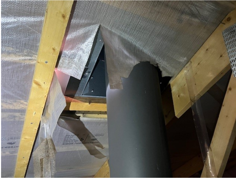
Bristfällig tätning i underlagstaket kring skorstenen.
