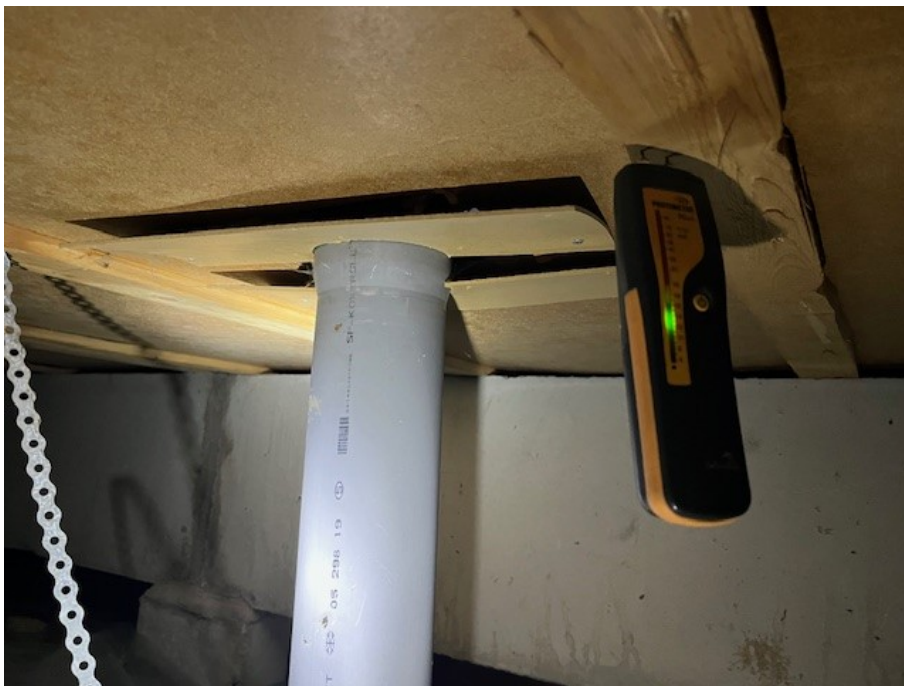
Fuktmätning i samt något bristfälligt tätat kring genomföring i krypgrunden.
