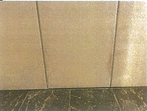
Missfärgning på kakelplatta.
