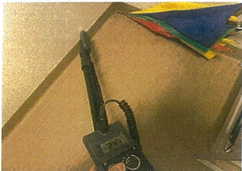
Normala fuktindikationer uppmättes på vägg mot badrum i klädkammaren.
