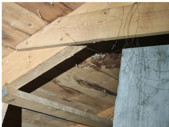
Exempelbild, fuktfläckar underlagstak, vind.
