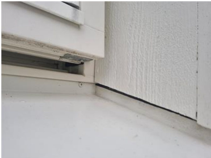
Exempelbild, otätheter kring fönsterbleck.
